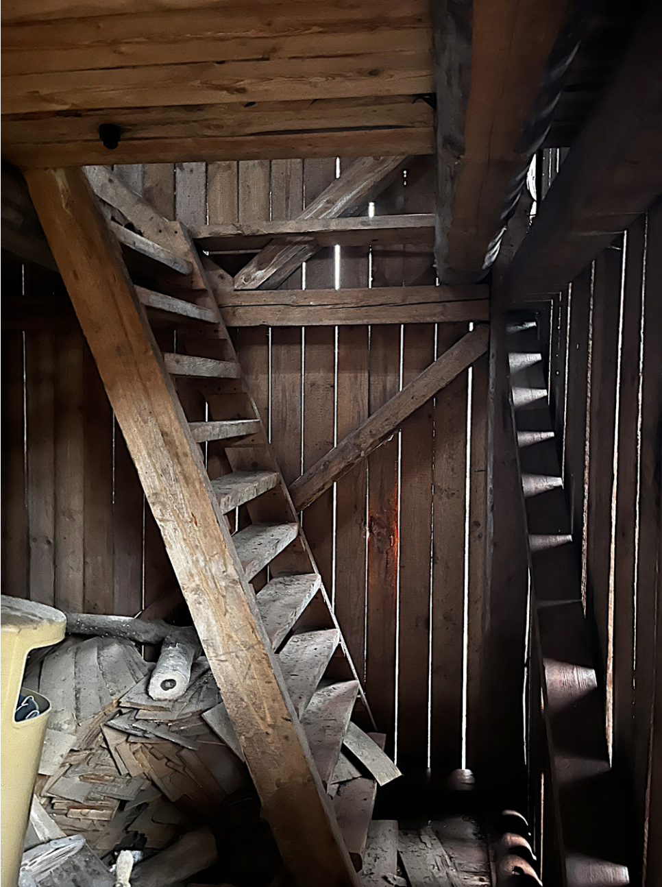
Näkymiä käpyvaraston sisätiloista. Pärekaton huonon kunnon vuoksi kattorakenteet ja yläparven tila ovat altistuneet kosteudelle. (Kuva ylhäällä oikealla: SEDU, kuvaaja Antti Virkkunen 2025)
